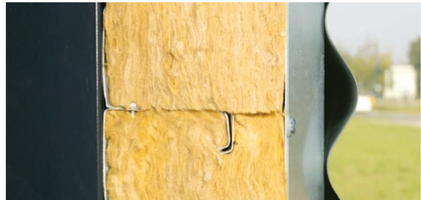
Goede verdeling van isolatie voor en achter de flens: geen risico op verminderde isolatiewaarde.
