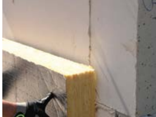
Lijmbaarde op het binnenspouwblad zijn vaak de veroorzaker van een valse luchtspouw.
